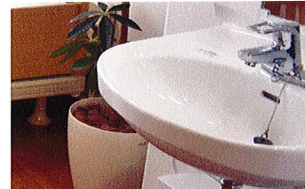
車いす対応洗面台
