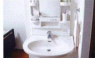
車いす対応洗面台
