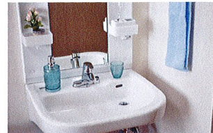
車いす対応洗面台
