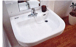
車いす対応洗面台(ベストライフ山科)
