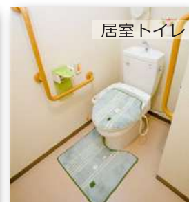
広々とした居室トイレは、安心の手すり完備。
