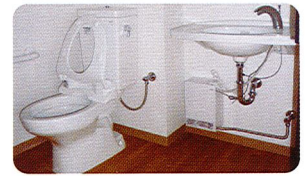
トイレ ウォッシュレット・手すり付 オート水栓
