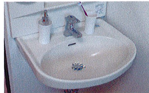
車いす対応洗面台
