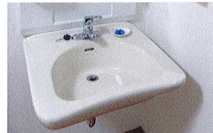
車いす対応洗面台
