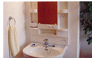
車いす対応洗面台
