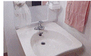
車いす対応洗面台
