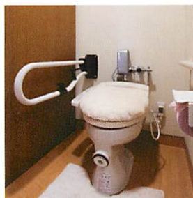
ウォシュレット付トイレ、介助バー、コールボタンも装備
