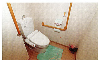
便座には、温水洗浄機能を装備。車イスでもラクラク利用でき、緊急ボタンも設置しています。
