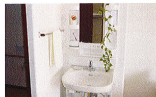
車いす対応洗面台
