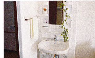
車いす対応洗面台
