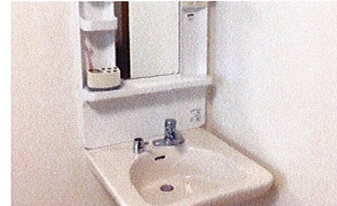
車いす対応洗面台
